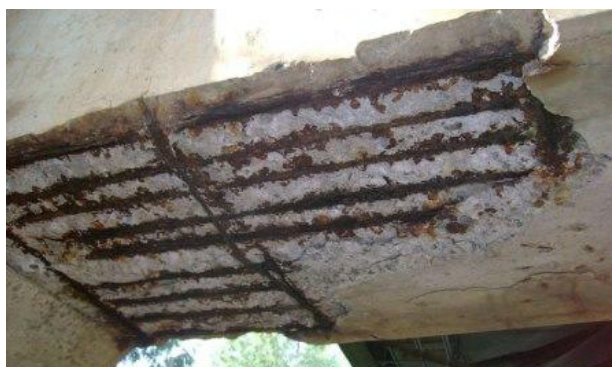
Mal estado concreto
